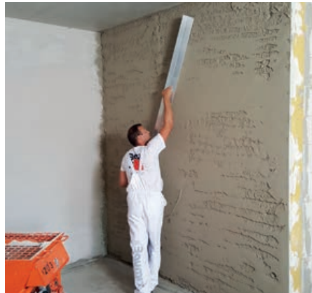
Obr. 2: Následně se povrch omítky nahrubo stahuje hliníkovou latí „h-profilu“ do roviny. Popřípadě se dostřikává materiál na požadovanou tloušťku vrstvy.
