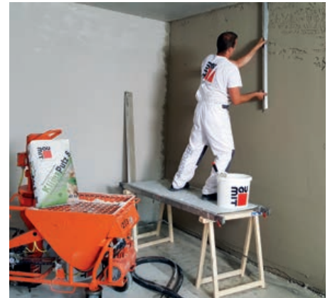
Obr. 3: Zavadnutý povrch omítky se následně seřízne trapézovou latí nebo nerezovou špachtlí. Tím se dosáhne požadované rovinnosti povrchu omítky.
