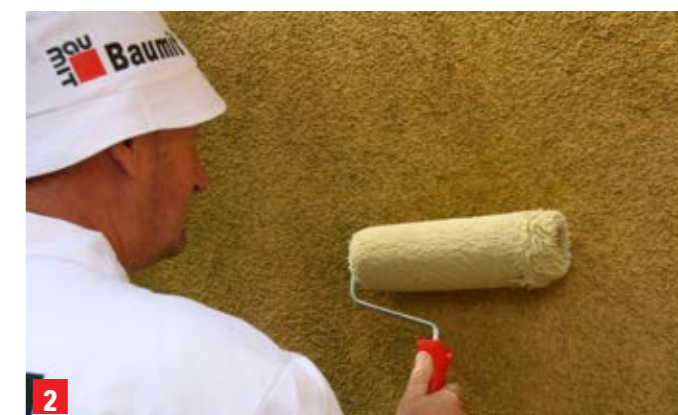
2 Řasami napadenou fasádu důkladně ošetřete přípravkem Baunit FungoFluid.
