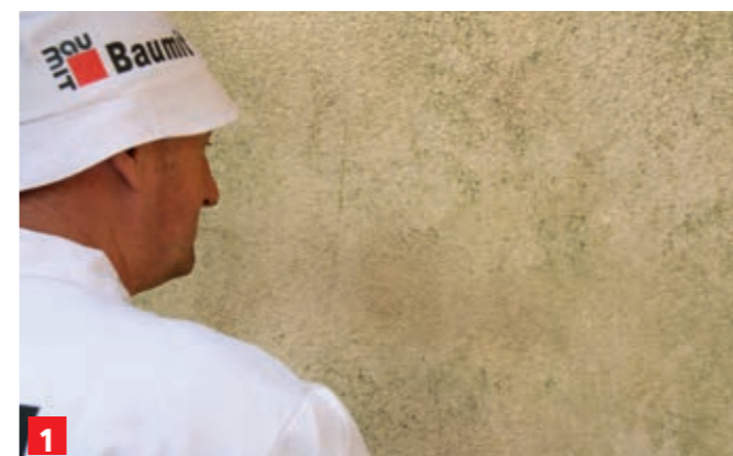
1 Před výběrem vhodné metody pro obnovu fasády je potřeba provést důkladný průzkum stavu povrchu.
