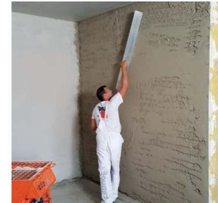
Obr. 2: Následně se povrch omítky nahrubo stahuje hliníkovou latí „h-profilu“ do roviny. Popřípadě se dostříká materiál na požadovanou tloušťku vrstvy.
