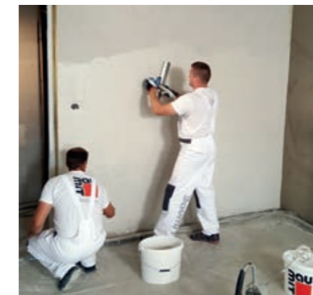
Obr. 5: Pro požadavek hladkých povrchů se nerezovým hladítkem aplikuje přírodně bílá vyhlazovací stěrka Baumit KlimaFino. V tomto případě se omítka nefilcuje, pouze se strhne do roviny viz obrázky č. 3.
