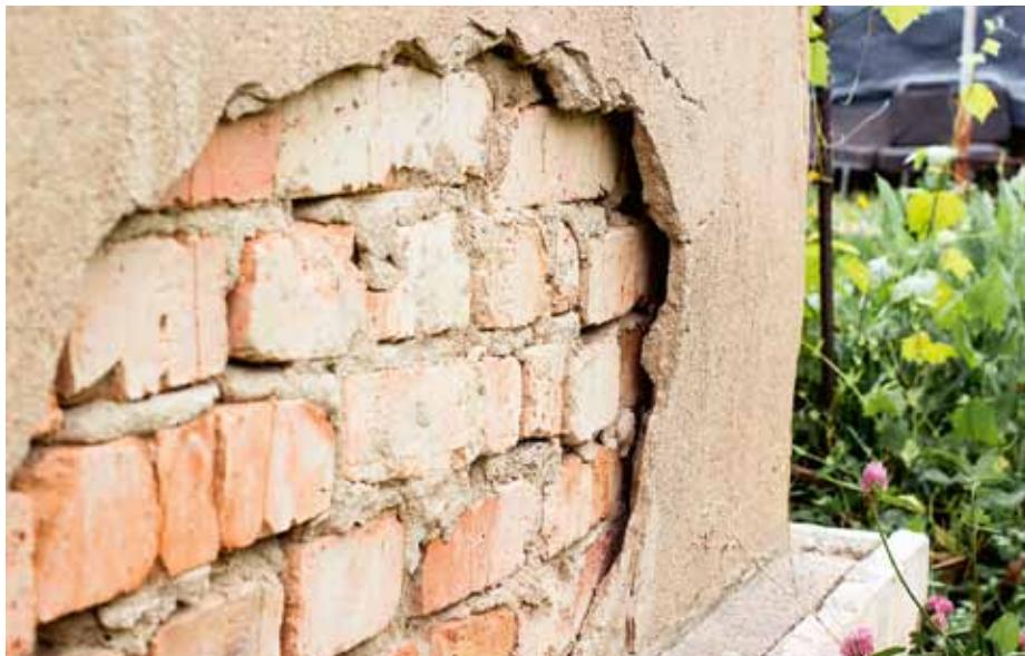
Vlhkost ve zdivu u starších objektů má často destruktivní účinky
