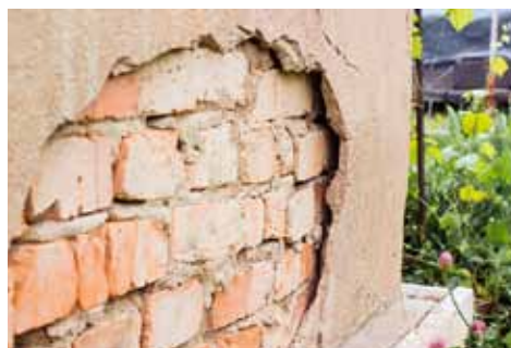
Vlhkost ve zdivu u starších objektů má často destruktivní účinky.
