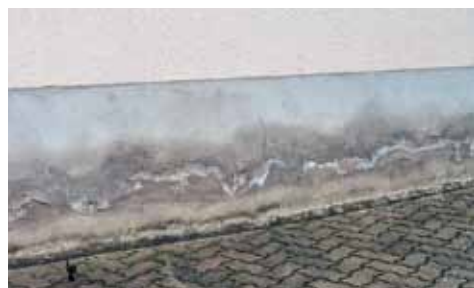
Zdivo se středním a vysokým obsahem vlhkosti a solí
