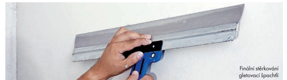
Lokální oprava nerovnosti povrchu
