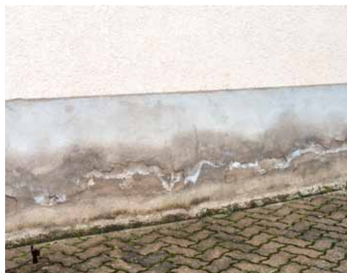
Zdivo se středním a vysokým obsahem vlhkosti a solí
