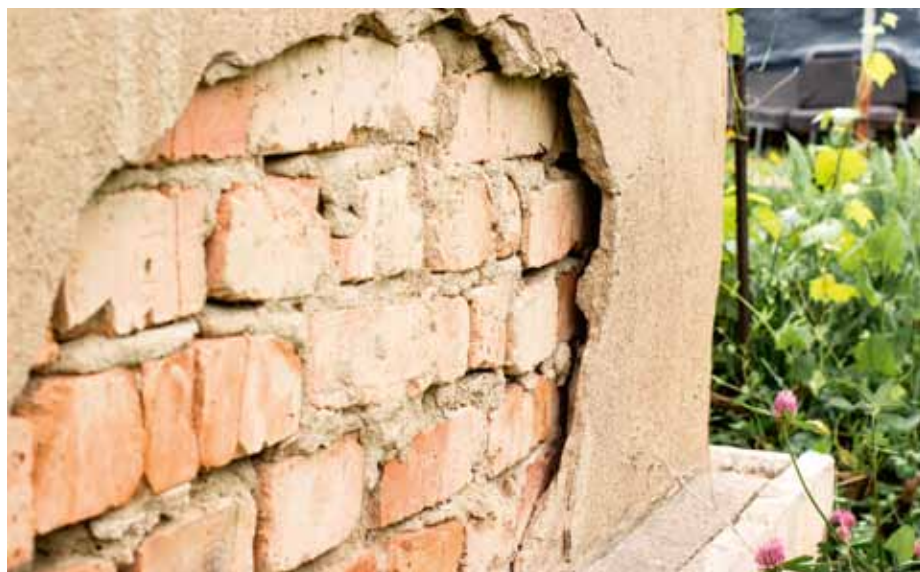
Vlhkost ve zdivu u starších objektů má často destruktivní účinky
