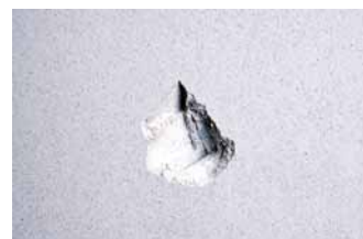
▲ Obr. 4 Lokální nerovnost povrchu
