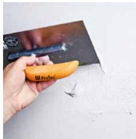
Lokální oprava nerovnosti povrchu
