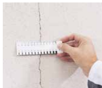
▲ Kontrola velikosti trhlin na fasádě
