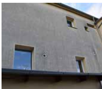
▲ Znečištěná fasáda domu před obnovou
