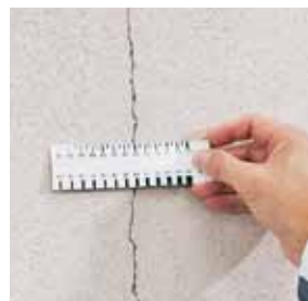
Kontrola velikosti trhlin na fasádě
