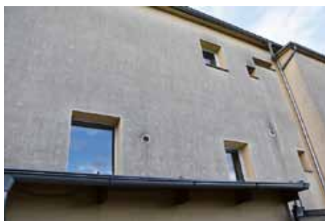
Znečištěná fasáda domu před obnovou
