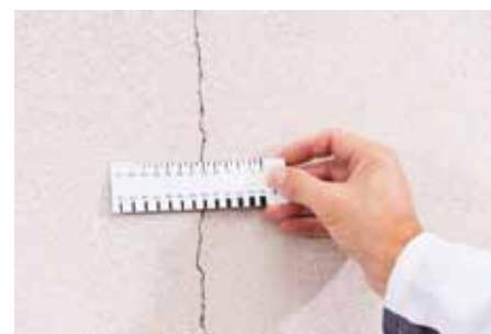
Kontrola velikosti trhlin na fasádě
