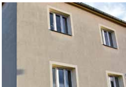
Znečištěná fasáda domu před obnovou
