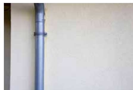
Finální stav obnovy domu po dvou nátěrech fasádní barvou Baumit StarColor – detail fasády
