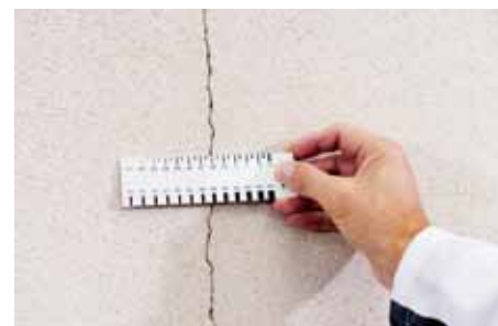
Kontrola velikosti trhlin na fasádě
