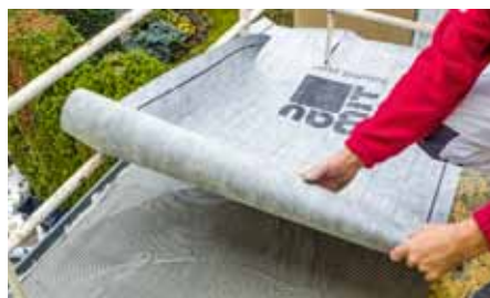
Baumit Baumacol AquaSafe, realizace – vtlačení hydroizolační membrány do rychletuhnoucího lepidla Baumit FlexTop Speed
