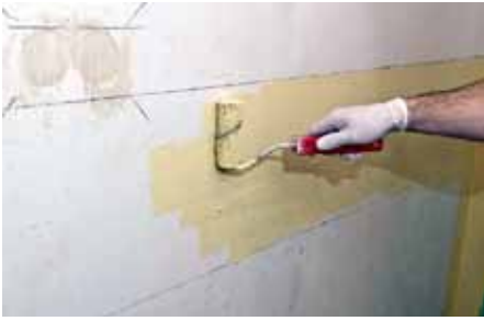
Následuje celoplošný hydroizolační nátěr Baumit Baumacol Proof, nanášený pomocí válečku či štětky.
