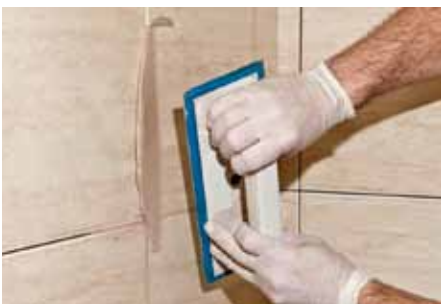
Po technologické přestávce min. 24 hod. je možné začít spárovat obklady a dlažby spárovací hmotou Baumit Baumacol PremiumFuge. Do spár se nanáší gumovou stěrku, popř. spárovacím hladítkem úhlopříčně k jejich směru.
