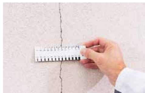
Kontrola fasády, ověření šířky trhliny pomocí kalibrovaného přípravku
